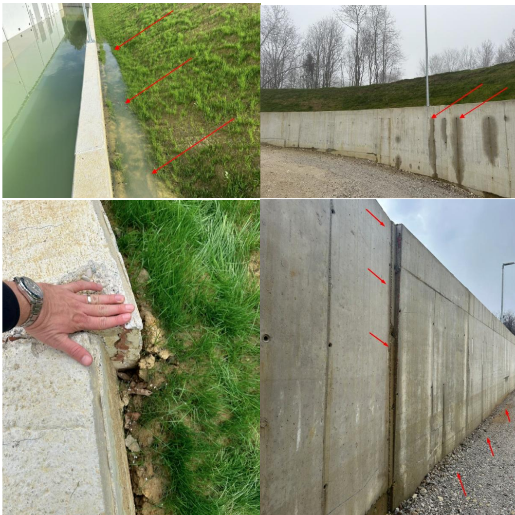
Slika 2. Situacija potpornog zida na lokaciji neposredno prije hazarda
